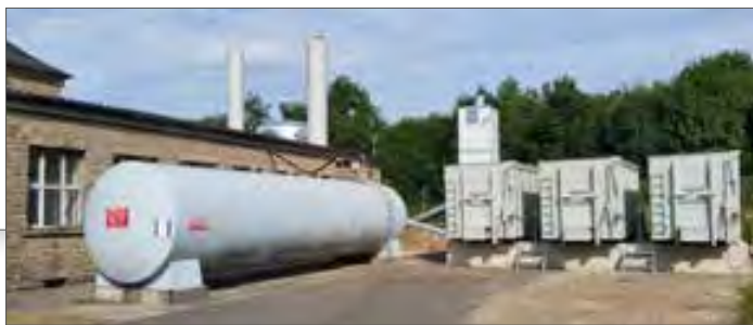
BHKW und hydraulische Schubbodencontainer für die Holzhackschnitzel
