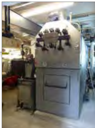
Biomasseheizwerk für Holzpellets
