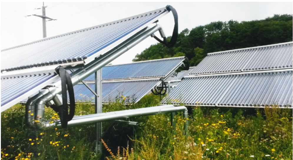
Solarthermieanlage (Bild: Verbandsgemeindewerke Simmern)
