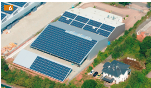
PV-Anlage Fa. Ellenberger, Kaiserslautern (Bild: damm-solar)
