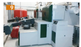
Kesselanlage (Bild: Energiegenossenschaft Kappel eG)
